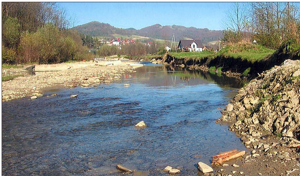
Fot. 4. Zniszczony brzeg (Foto: Cz. Lipski) Photo 4. Devastated of banks
