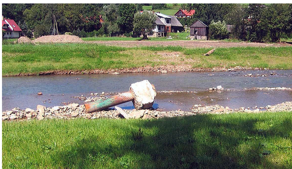
Fot. 5. Rura limnigraficzna wyrwana i przemieszczona przez wodę. Brzegi uregulowane i obsiane trawą (Foto: Cz. Lipski) Photo 5. Limnograph tube devastated end translocated by water. Banks are regulated and grasses
