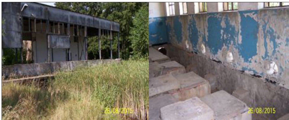
Fot. 1. Zdevastowane budynki przepompowni w Niepruszewie i Jeziorkach w 2015 roku Fot. 1. Devastated buildings pumping stations in Niepruszewo and Jeziorkach in 2015
